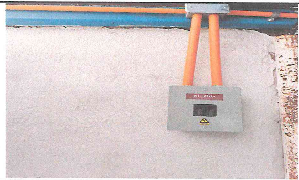
Foto 2: sistema eléctrico HABILITADO Y funcional.
